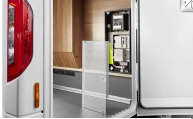
Elcentral lättåtkomligt placerad i skotergarage
